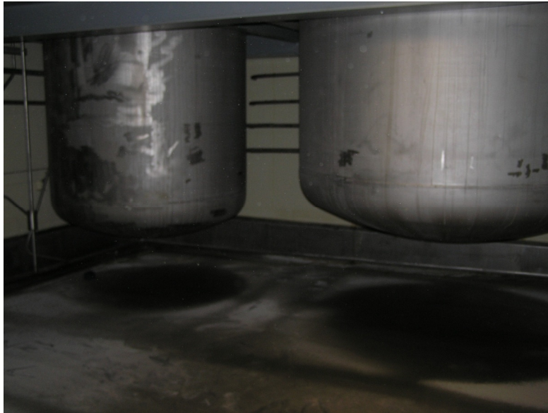
Figuur 3.3: Tank 8153B1 (rechts) en tank 8153B2 (links)
