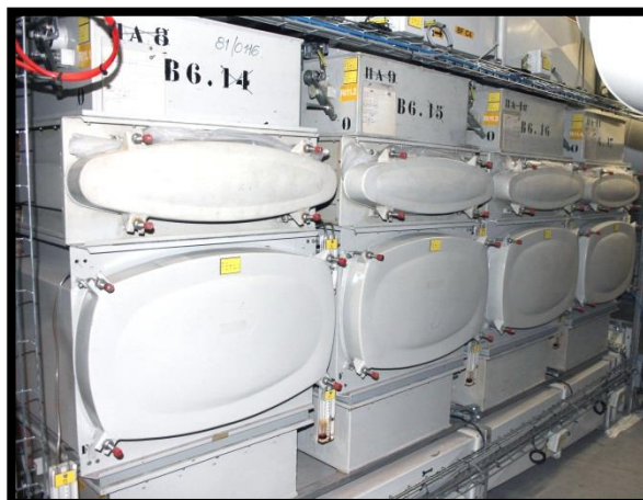
Figuur 13: Filterbatterijen voor aërosolen op een ventilatienetwerk van het IRE vóór hun lozing via de schoorsteen
