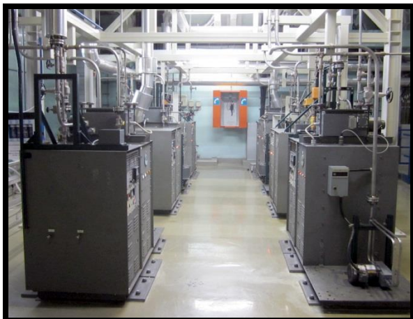
Figuur 14: Toestellen voor de permanente controle van de gasvormige lozingen in de kerncentrale van Tihange
